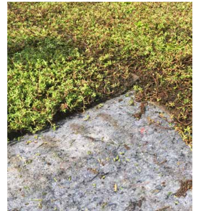
↓ Moos-Sedum Matten Vorbegrünte Moos-Sedum Matten auf Speichervlies. Aufgelegt auf auf Drahtgittermatten
